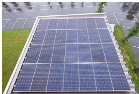
太陽光パネル
